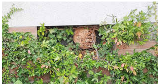
Foto: Irmgard-Forster Seiwert, ausgebautes Primärnest hinter Kletterpflanzen unter dem Kellerfenster
